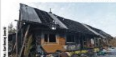
Ruiny domu po pożarze w Plekietniku.
